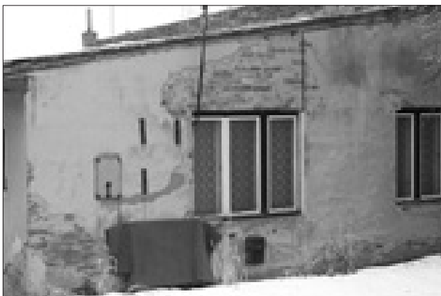
Kuželna, která je v havarijním stavu, bude demolována a nahrazena novým jednopodlažním objektem
